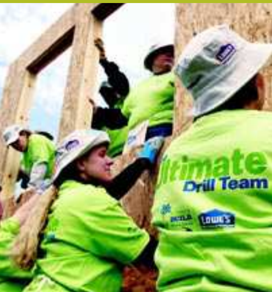
Mujeres voluntarias de Women Build ayudan a construir una pared en Detroit, MI
